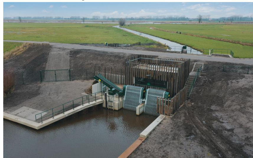
Figuur 8: Gemaal Cellemuiden (duurzaam gemaal)
